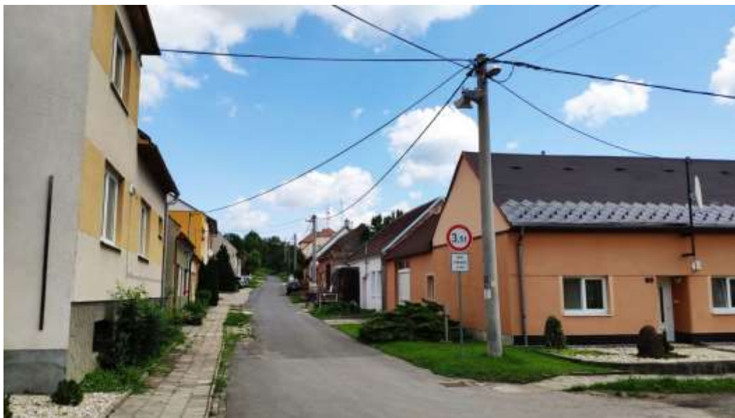
Obr. 128: Charakter VO v převážné části ulic s obytnou zástavbou - svítidla technického typu jsou osazena na výložnicích ze stožárů energetických rozvodů. Svítidlo bez důrazu na design.
