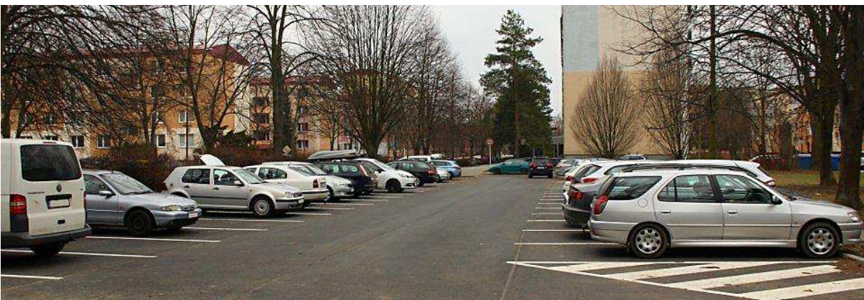
Rekonstrukce ul. Lechova (mezi ul. Rostislavova a 28.října), velkoplošné opravy vozovek (ul. Pplk. Štěrbý, ul. Na Stavidle, Pod Vinohrady, parkoviště ve Štěpnicích u BD čp. 1095)
