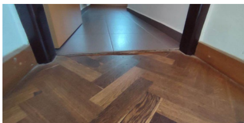
Příloha 8 – WC ženy, chybějící přechodová lišta
