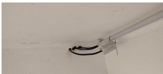
Příloha 5 – elektroinstalace v kuchyni
