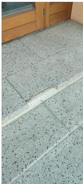
Příloha 3 – poškozený schodišťový stupeň
